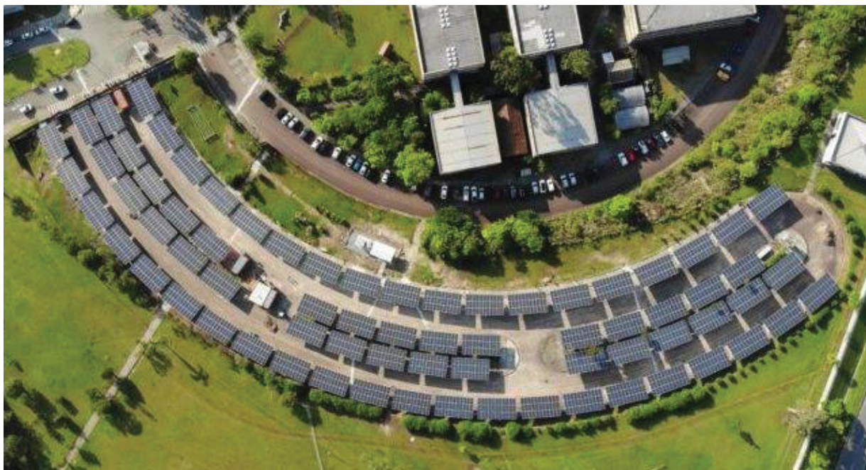
FIGURA 4 – FOTO DA USINA FOTOVOLTAICA BIOLÓGICAS UFPR
