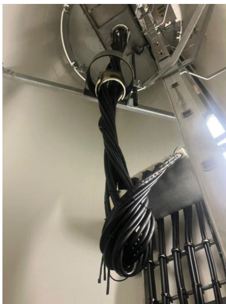
FIGURA 7: CABOS DOS SISTEMA DO YAW ENROLADOS
