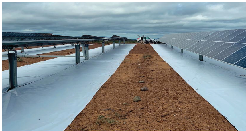
FIGURA 11 - MANTA REFLEXIVA APLICADA EM SISTEMAS FOTOVOLTAICOS
