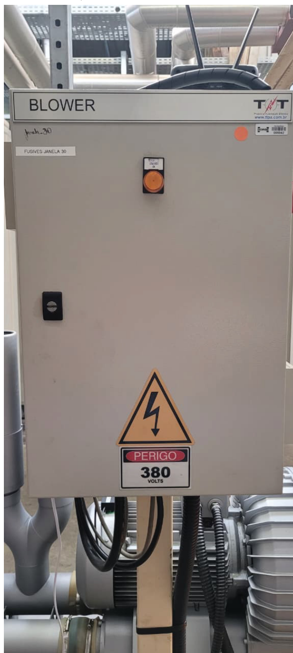
FIGURA 23 – Quadro de Acionamento Elétrico Blower
