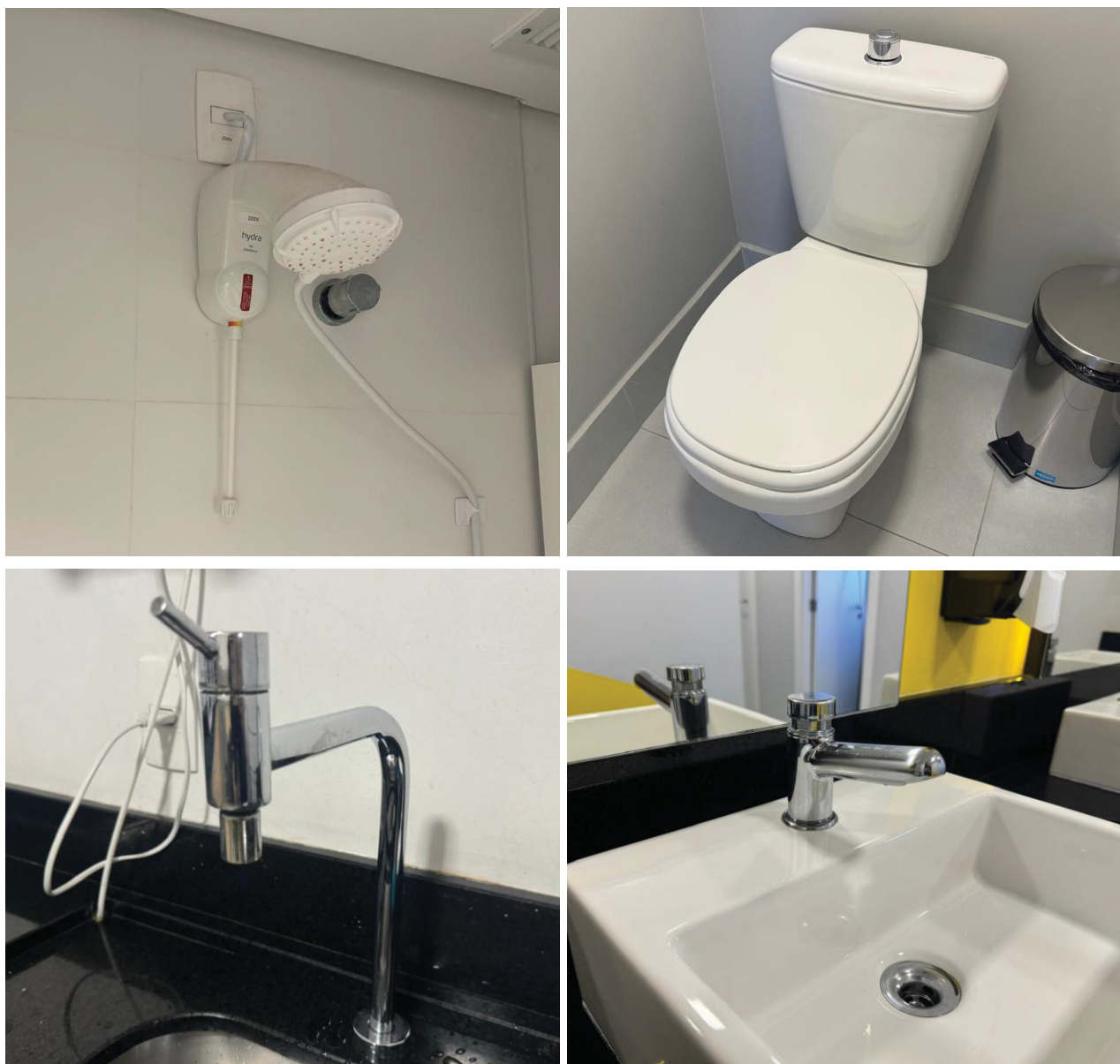
Figura 7 – Louças e metais utilizados no edifício
