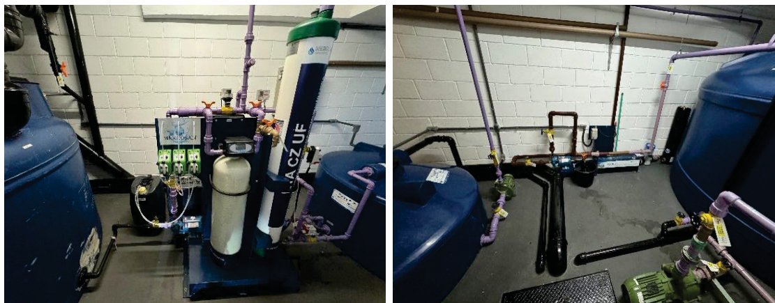
Figura 4 - Sistema de tratamento e armazenamento de águas cinzas
