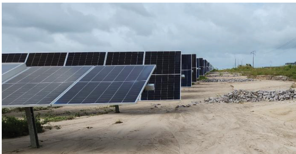
FIGURA 6 – SEGUIDOR SOLAR SEM RASTREAR
