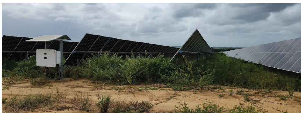
FIGURA 5 – EXEMPLO DE SOMBREAMENTO DE VEGETAÇÃO NOS MÓDULOS FV
