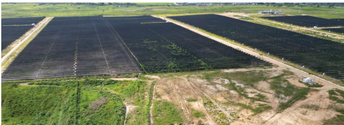
FIGURA 13 – VEGETAÇÃO ALTA ENTRE SEGUIDORES SOLARES
