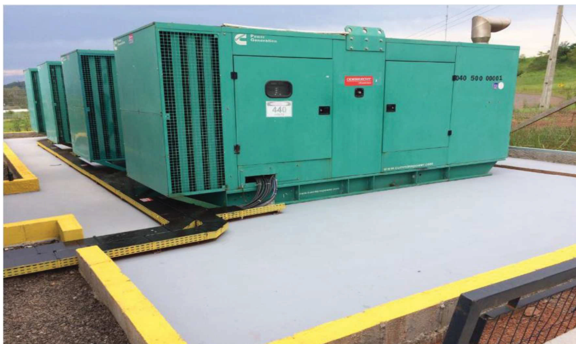
Figura 4 – Central de Geração à Diesel.
