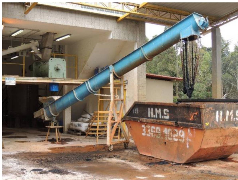
FIGURA 12 – UNIDADE DE DESAGUAMENTO DA ETE SANTA QUITÉRIA
