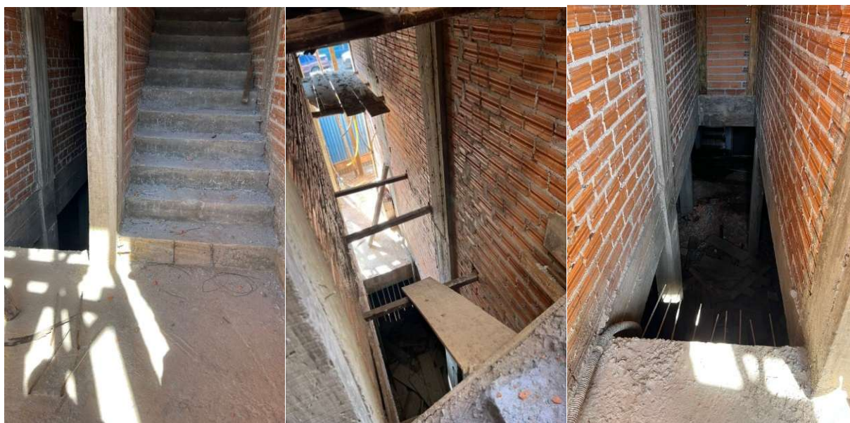
FIGURA 8 - IRREGULARIDADES NA OBRA A.
