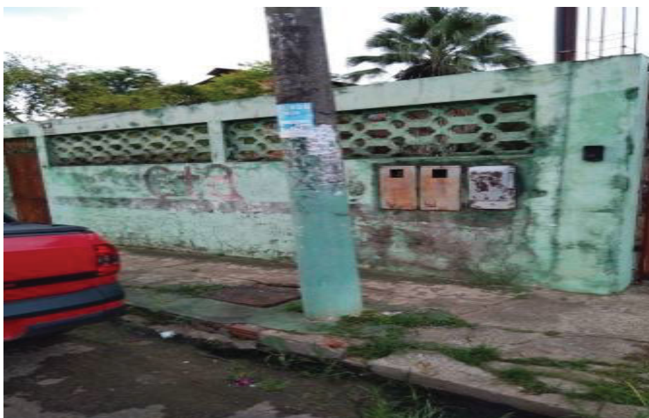
Figura 123 – Muro da sede do CTA abandonada em Rio Branco. Fotos tiradas em 2022.
