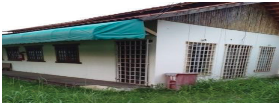
Figura 124 – Escritório do CTA em Rio Branco. Está abandonado. Foto tirada em 2022.
