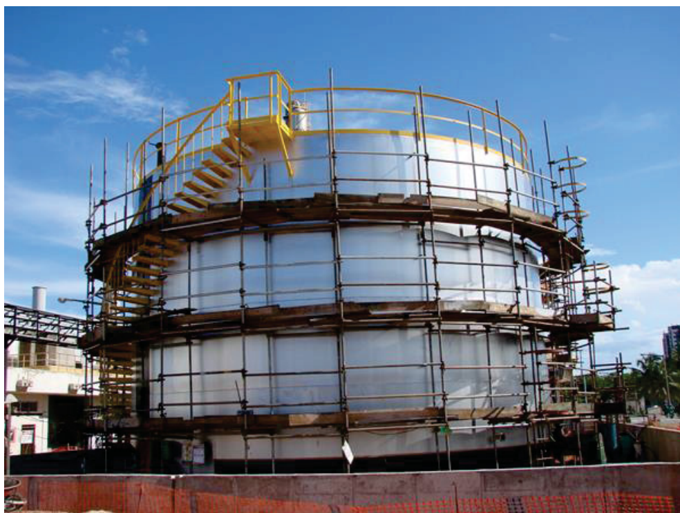
Figura 07 - Arqueação de Tanques, detalhe para as plataformas de trabalho e andaimes, equipamentos previstos pela norma ISO 7507-1
