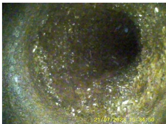
Figura 30 - Foto do Boroscópio evidenciando grande quantidade de mexilhões, lama e hidrozoários na tubulação do Mancal, antes do sistema UV HOD.
