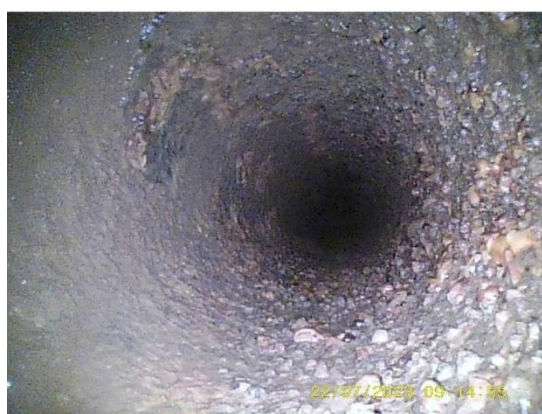
Figura 31 - Foto do Boroscópio sem mexilhões, lama ou hidrozoários na tubulação do Mancal, depois do sistema UV HOD. Os pontos observados na foto são de corrosão na tubulação.
