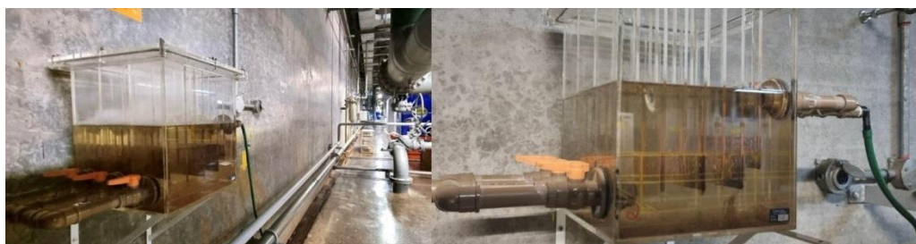
Figura 6 - Biobox instalado no sistema de resfriamento da Usina de Salto Caxias.
