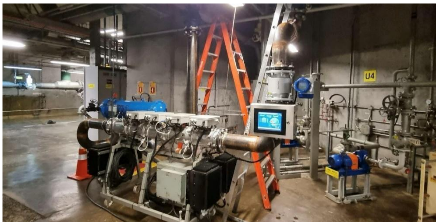
Figura 7 - Ultravioleta HOD instalado no sistema de resfriamento da máquina 4, da Usina Governador José Richa
