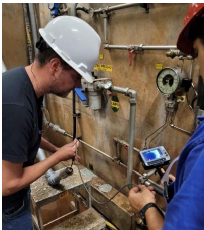
Figura 13 - Utilização do boroscópio em tubulação do sistema de resfriamento
