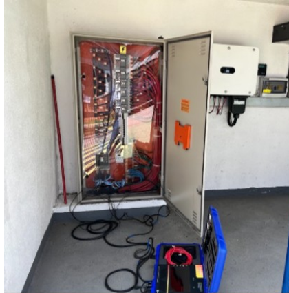
Figura 33: Equipamento de Qualidade de Energia Instalado
