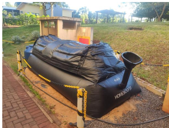
FIGURA 7 – BIODIGESTOR EM OPERAÇÃO
