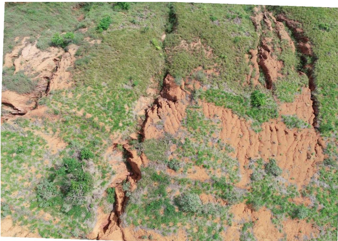
Figura 26 Imagem aérea obtida com RPA Phantom 4 em Periquito, MG, demonstrando a presença de processos erosivos nas áreas de interesse. Fonte: Autora (2021)
