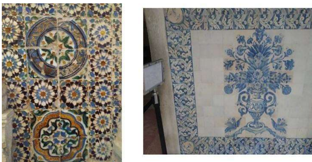
Figura 3: Detalhes de degradação física e estética, Coimbra, Portugal. FONTE: Acervo dos autores (2021).
