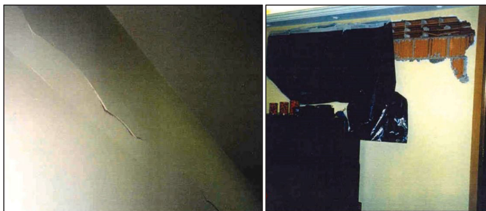
FIGURA 1 – Manifestações patológicas na interface alvenaria-estrutura
