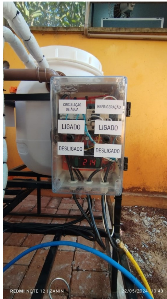
Figura 17 – Painel de controle do Chiller
