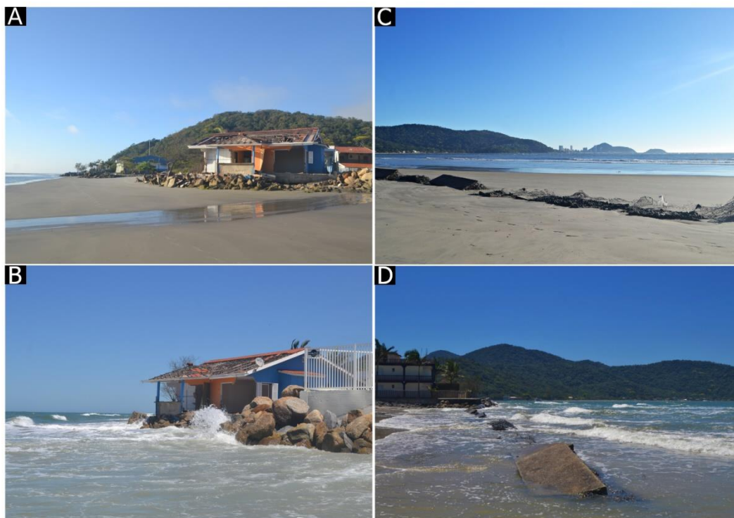
FIGURA 11 - EVIDÊNCIAS DO RECUO DA LINHA DE COSTA EM CAIEIRAS: IMAGENS EM CONDIÇÕES DISTINTAS DE MARÉ (A E C - MARÉ VAZANTE; B E D - MARÉ ENCHENTE) DE ENROCAMENTOS DE ROCHAS E RESIDÊNCIA E MURO DE CONTENÇÃO DESTRUÍDOS.
