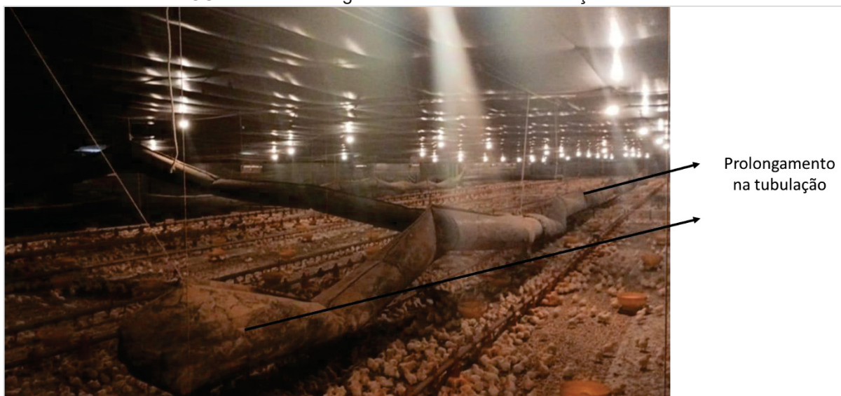
FIGURA 22 – Prolongamento no tubo de distribuição de calor
