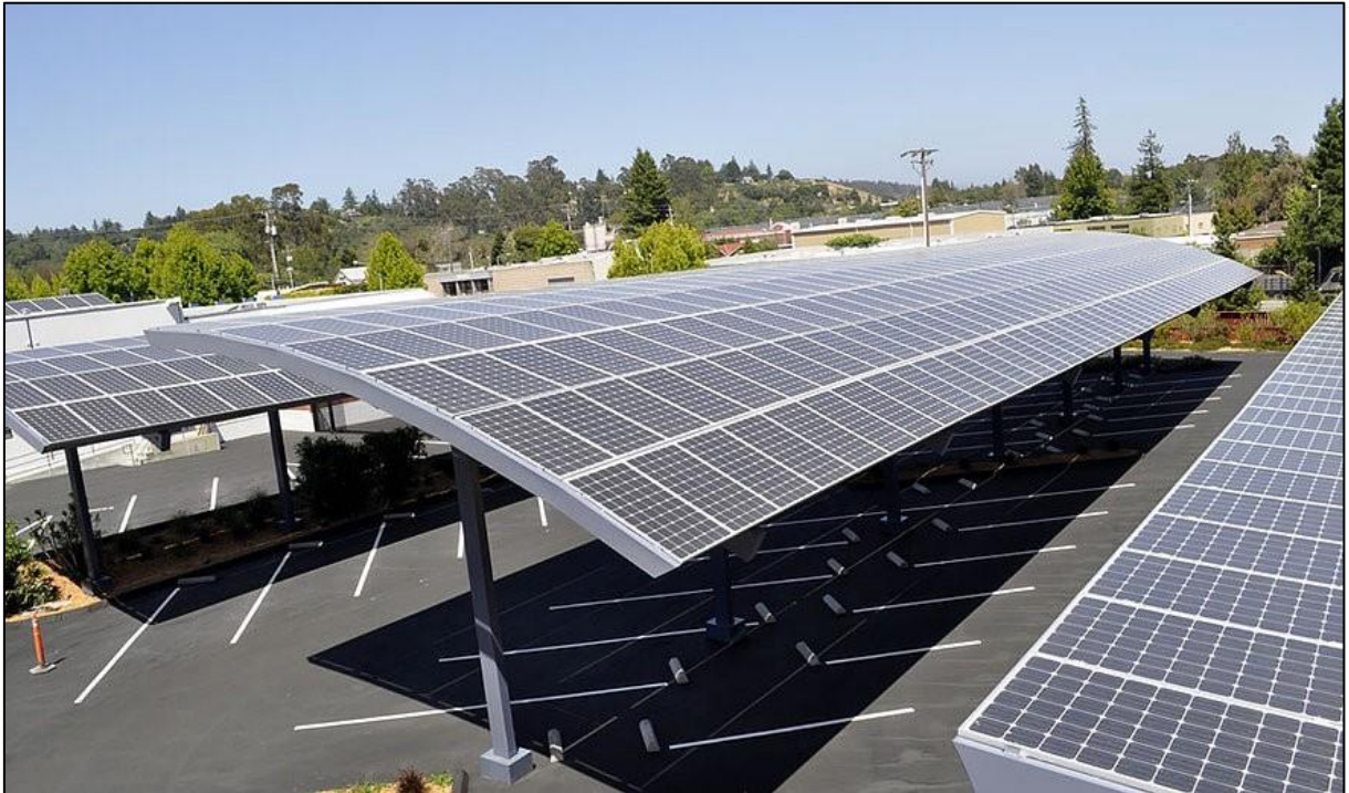
Figura 5 - Estrutura Carport com Painéis Solares
