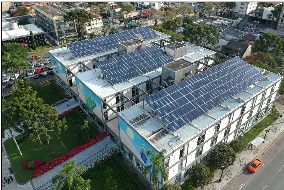
Figura 6 - Usina Solar Fotovoltaica no Prédio da Prefeitura Municipal de Curitiba
