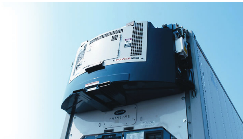
FIGURA 15 - Genset com clipe preso a lateral do contêiner
