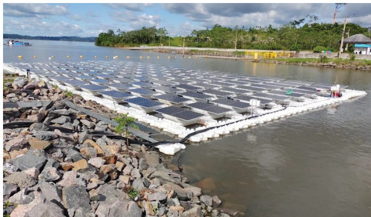
Figura 9 - Sistema fotovoltaico flutuante do rio Xingu no reservatório UHE Pimentel - Complexo UHE Belo Monte.
