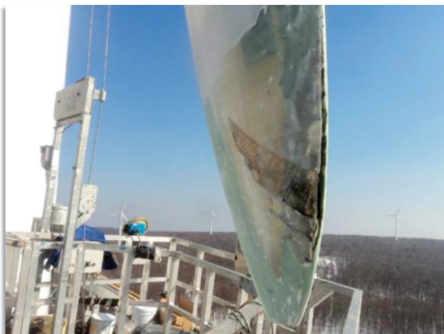
Figura 5 - Pá eólica danificada por um raio.
