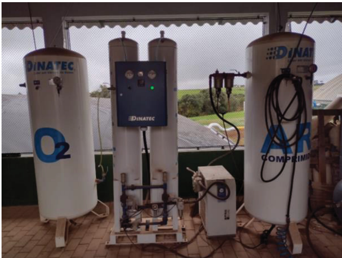
FIGURA 6: SISTEMA DE INJEÇÃO DE OXIGÊNIO PARA PURIFICAÇÃO DO BIOGÁS EM CASTRO-PR
