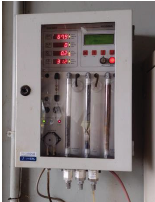
FIGURA 7: PAINEL ELETRÔNICO PARA CONTROLE DE PUREZA E INJEÇÃO DE OXIGÊNIO CASTRO - PR
