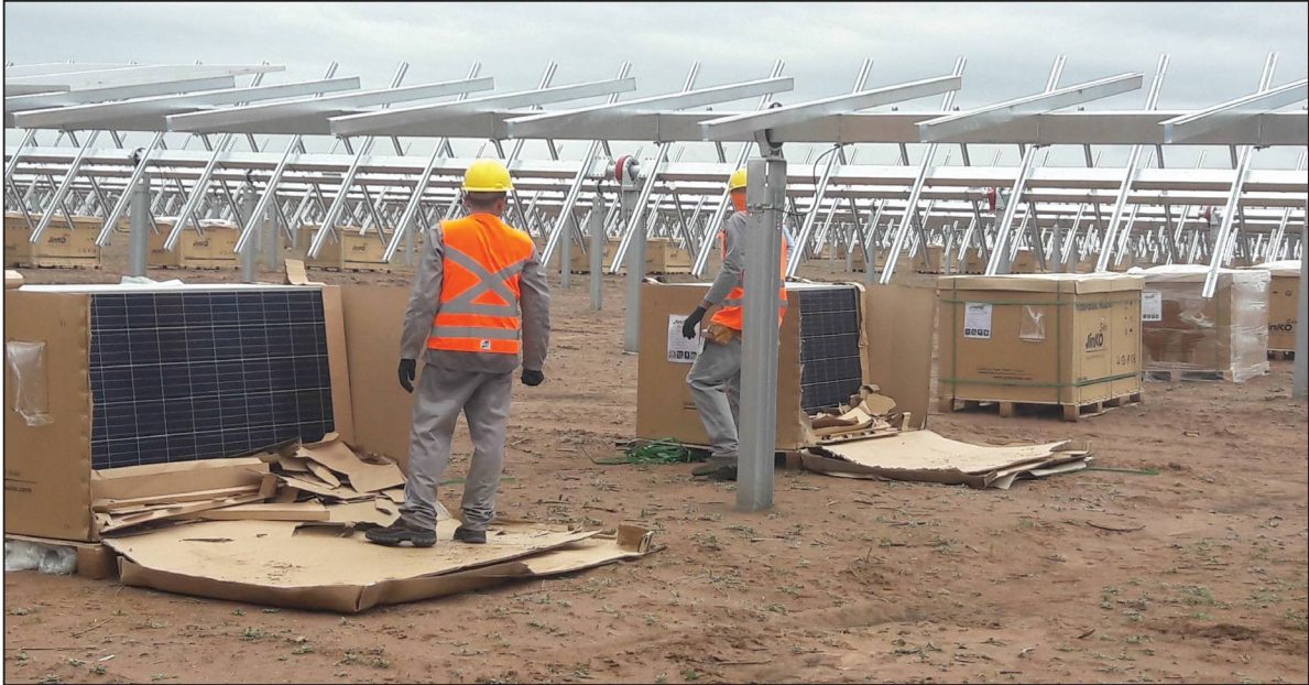
Figura 2: Abertura das Caixas - Modulo Fotovoltaico KM315P-72 – 295 – 315 Watt POLY CRYSTALLINE MODULE Positivo Power da fabricante Jinko Solar.
