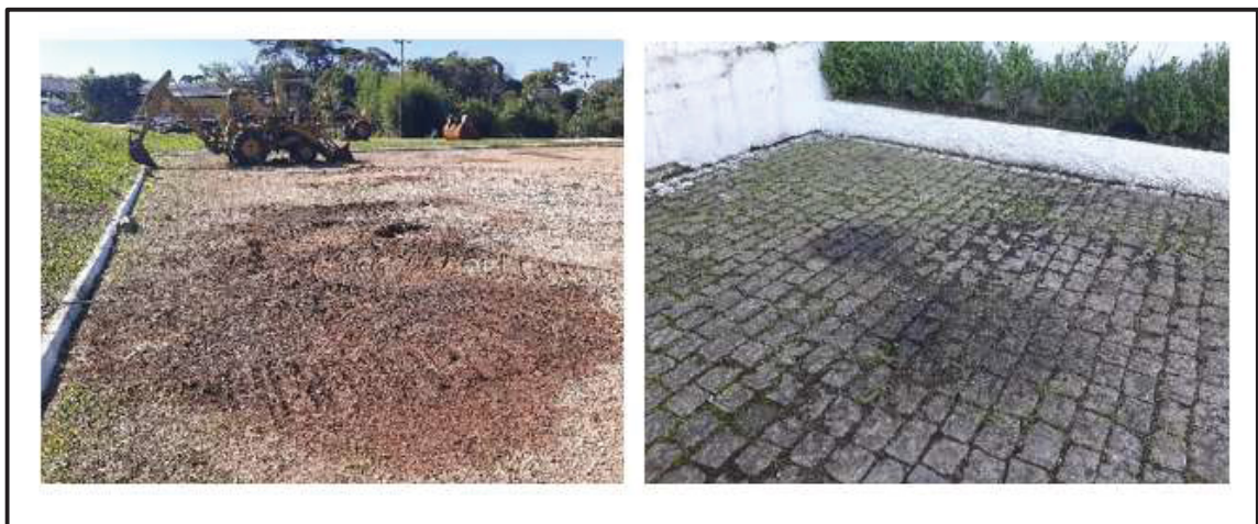
FOTOS 1 e 2 – VAZAMENTO DE ÓLEO LUBRIFICANTE USADO NO PÁTIO DE ESTACIONAMENTO DE EQUIPAMENTOS
