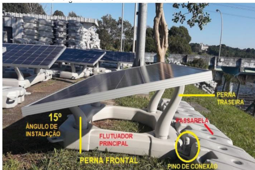
FOTO 9 – MÓDULO INSTALADO UFF SANEPAR
