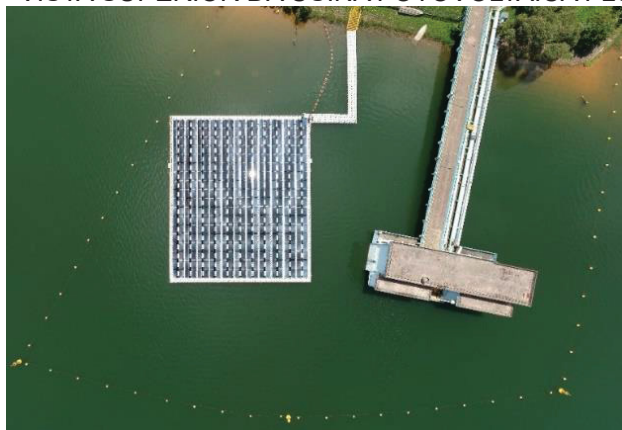
FOTO 3 – VISTA SUPERIOR DA USINA FOTOVOLTAICA FLUTUANTE
