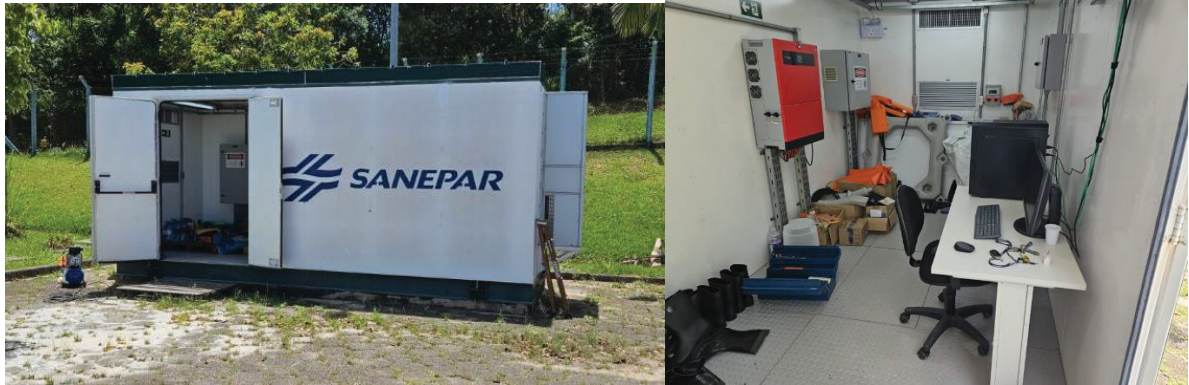
FOTOS 4 e 5 – ELETROCENTRO DA UFF SANEPAR: POR FORA E POR DENTRO
