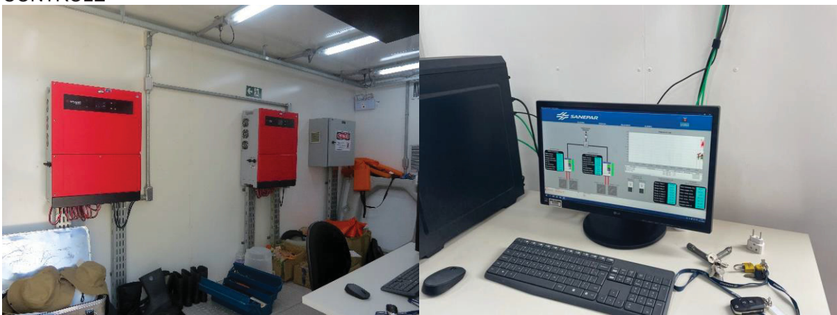
FOTOS 6 e 7 – DENTRO DO ELETROCENTRO: INVERSORES E SISTEMA DE SUPERVISÃO E CONTROLE
