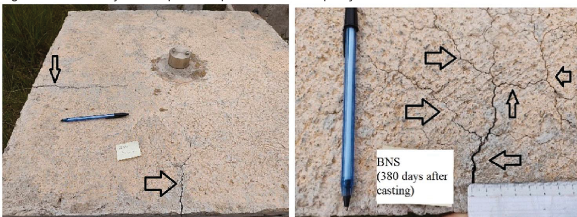
Figura 20 – Fissuração na superfície após um ano de exposição no ambiente natural.
