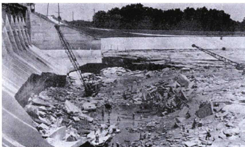
FIGURA 4.11 - EROSÃO A JUSANTE DO VERTEDOIRO.
