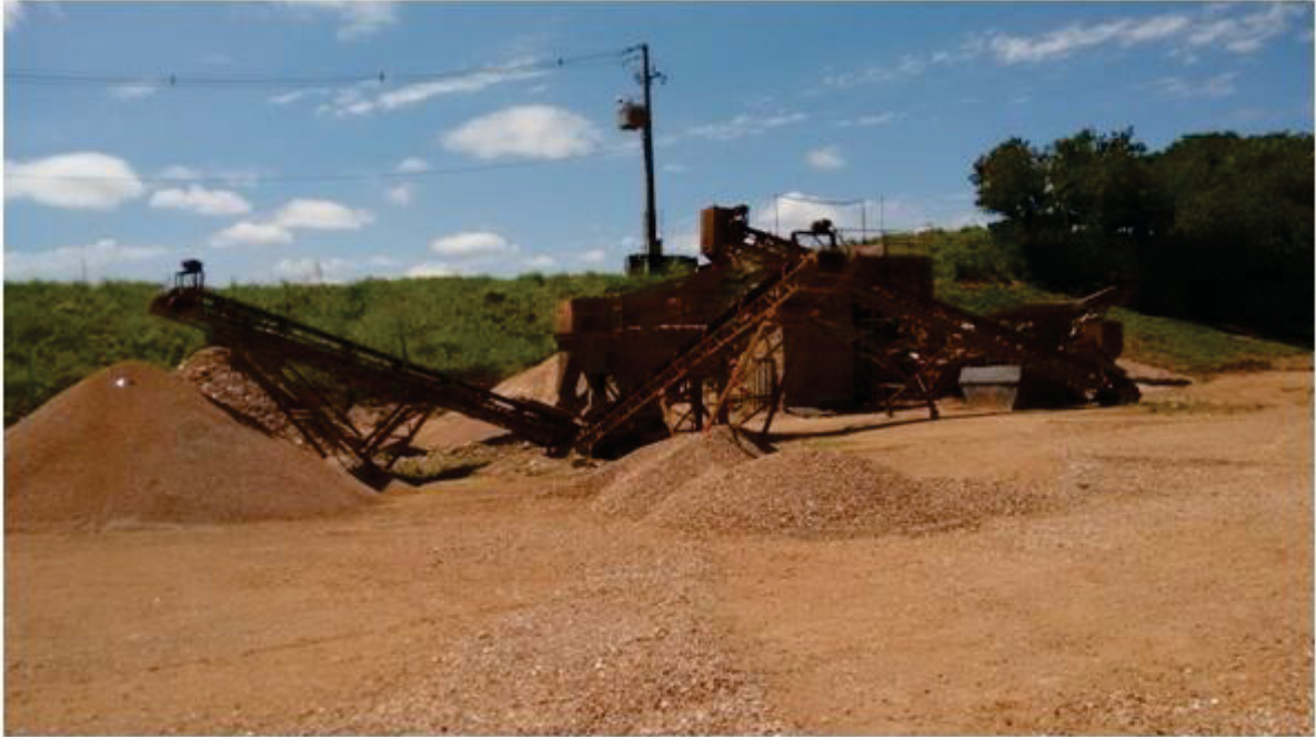
FIGURA 5 - CENTRAL DE RECICLAGEM DE RCC NO MUNICÍPIO DE LONDRINA/PR
