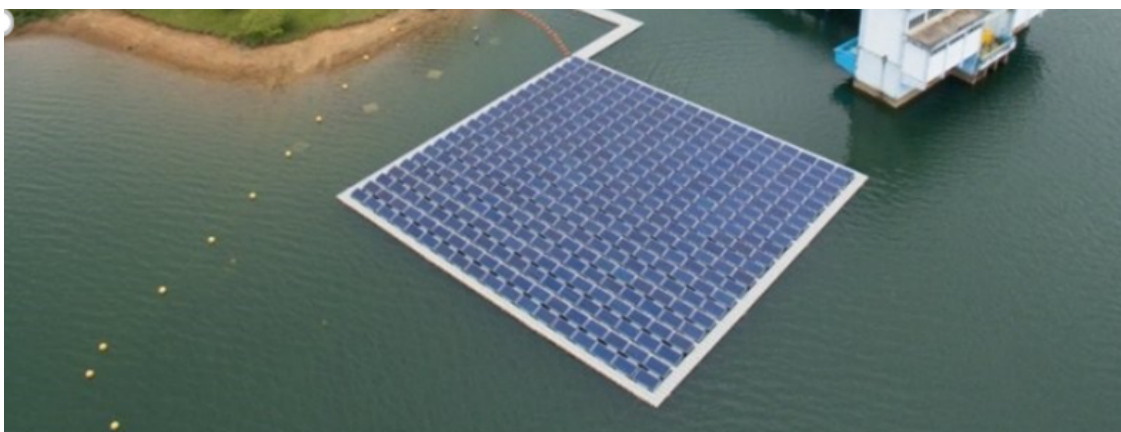
Figura 1 – Usina fotovoltaica flutuante no lago Passaúna (Curitiba-PR, Brasil).
