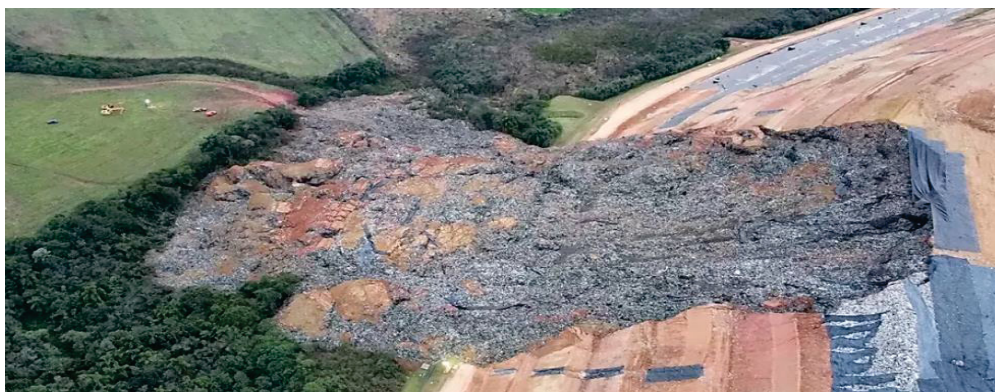
FIGURA 13- DESLIZAMENTO EM ATERRO DE FAZENDA RIO GRANDE-PR
