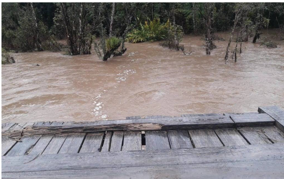
FIGURA 42 - Ponte de madeira sobre o rio local: enchente
