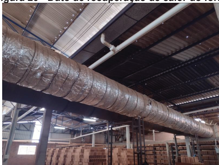
Figura 20 - Duto de recuperação de calor do forno
