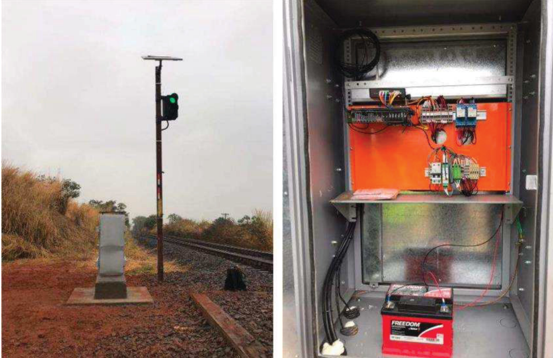
Figura 23. Vista Geral do Sistema MPA instalado
