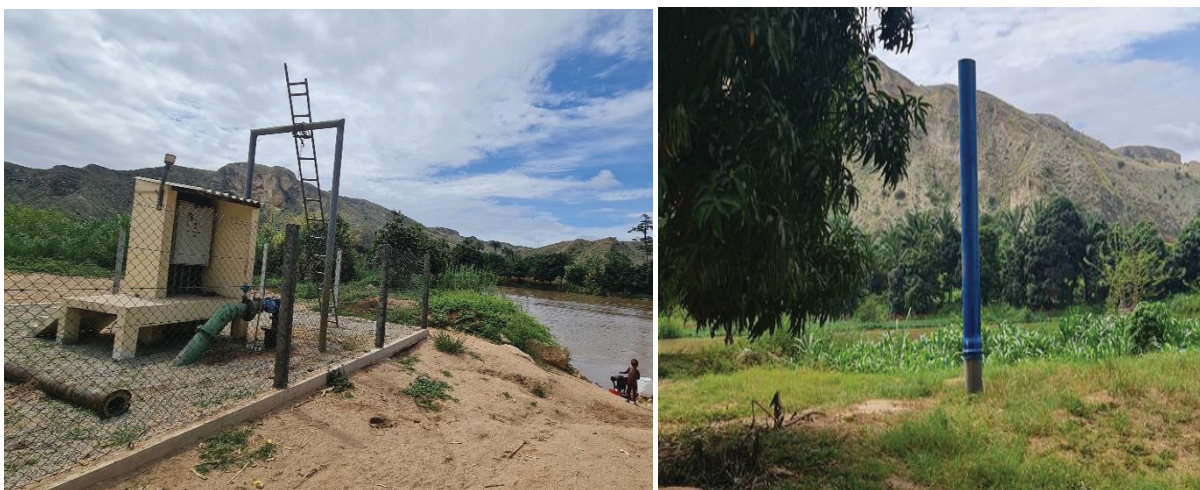
FIGURA 9: CAPTAÇÃO DE ÁGUA SUBTERRÂNEA
