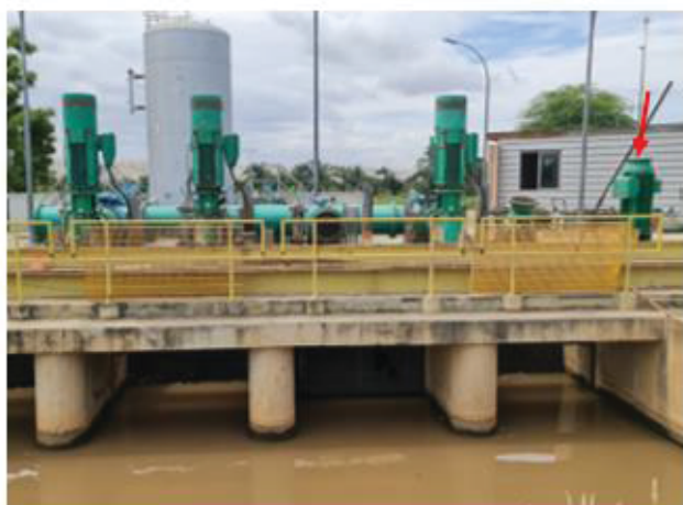
Bombeamento da água bruta
