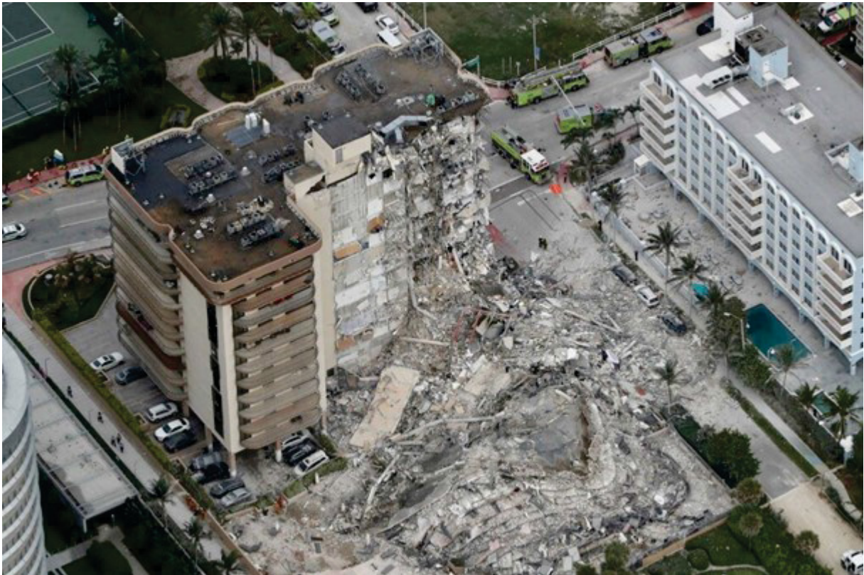
FIGURA 2 – Colapso desproporcional do edifício localizado em Miami (2021).
