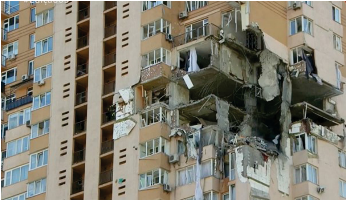
FIGURA 3 – Edifício em Kiev (2022).
