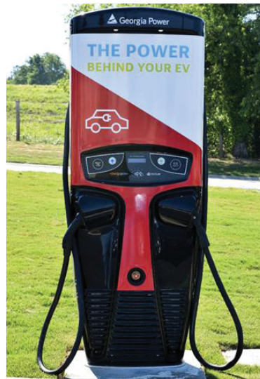
FIGURA 8: ESTAÇÃO DE CARREGAMENTO CC PARA CARREGAMENTO RÁPIDO
