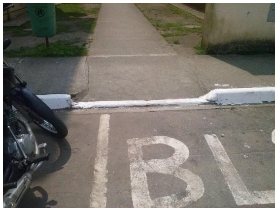
FIGURA 1: Rampa de acesso em um estacionamento de um condomínio FONTE: As autoras (2014)
