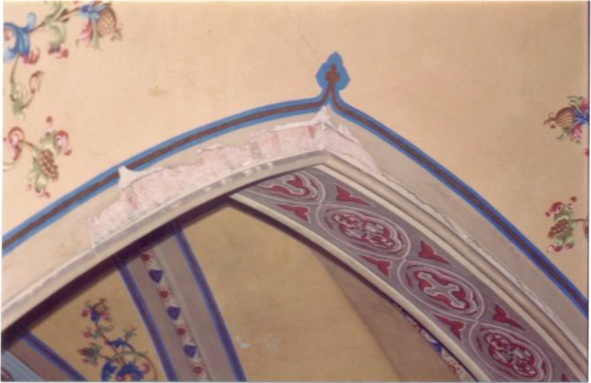
FIGURA 62 – PERDA DE REBOCO NA ABÓBADA CENTRAL (1)
