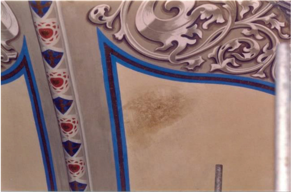
FIGURA 60 – MANCHAS NAS PINTURAS DA ABÓBADA CENTRAL (2)
