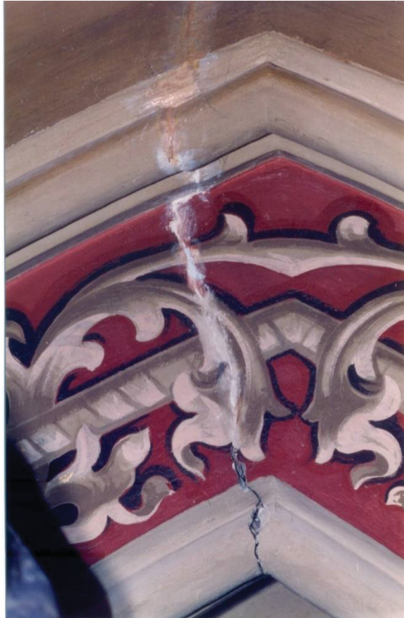
FIGURA 66 – RACHADURA NA ABÓBADA CENTRAL (2)
