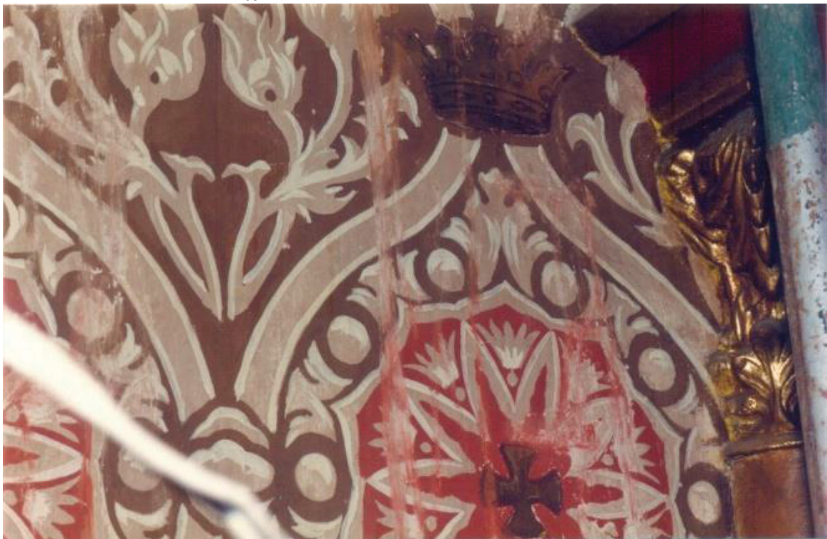
FIGURA 65 – MANCHAS NAS PINTURAS DA CAPELA-MOR
