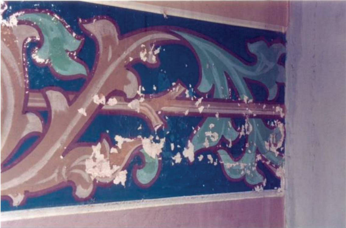
FIGURA 34 – PINTURA DANIFICA NO BARRADO INTERNO DA IGREJA
