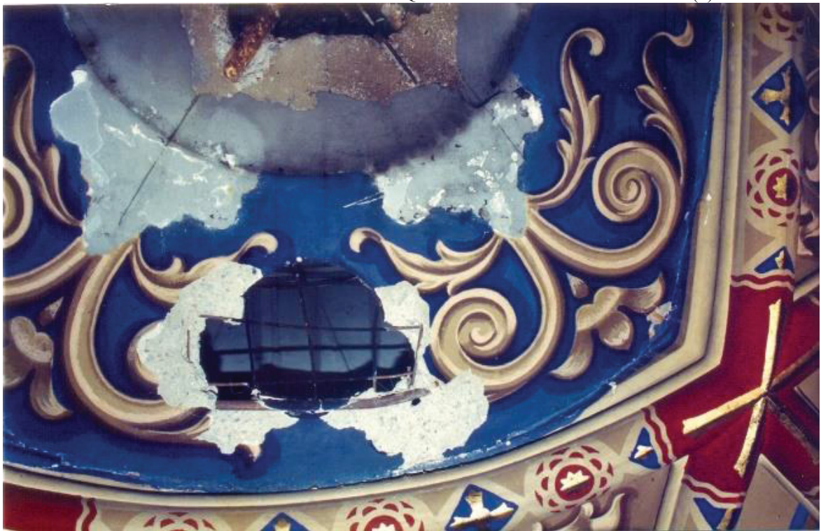
FIGURA 42 – ABERTURA DE ESTUQUE NO ÓCULO DO LANTERNIM (1)
