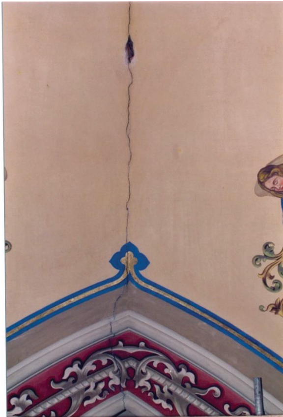
FIGURA 63 – RACHADURA NA ABÓBADA CENTRAL (1)
