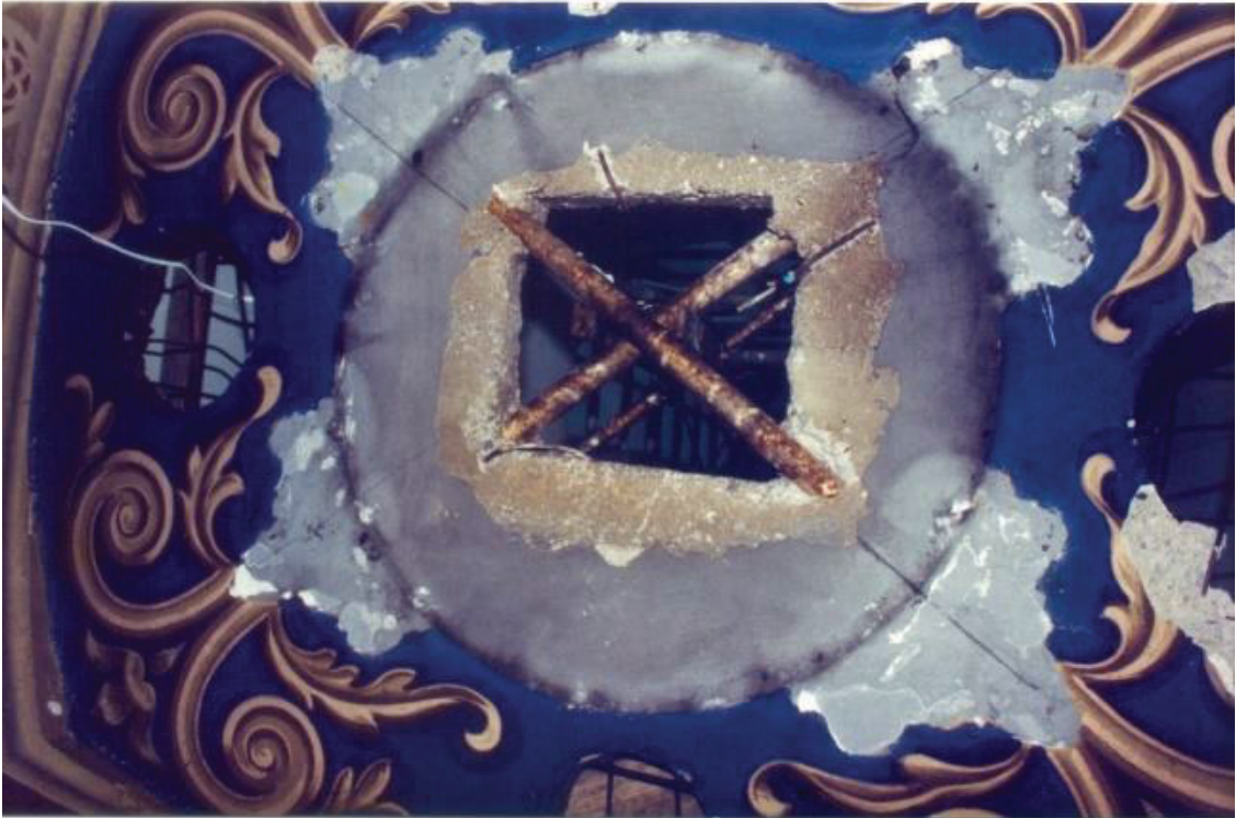
FIGURA 43 – ABERTURA DE ESTUQUE NO ÓCULO DO LANTERNIM (2)
