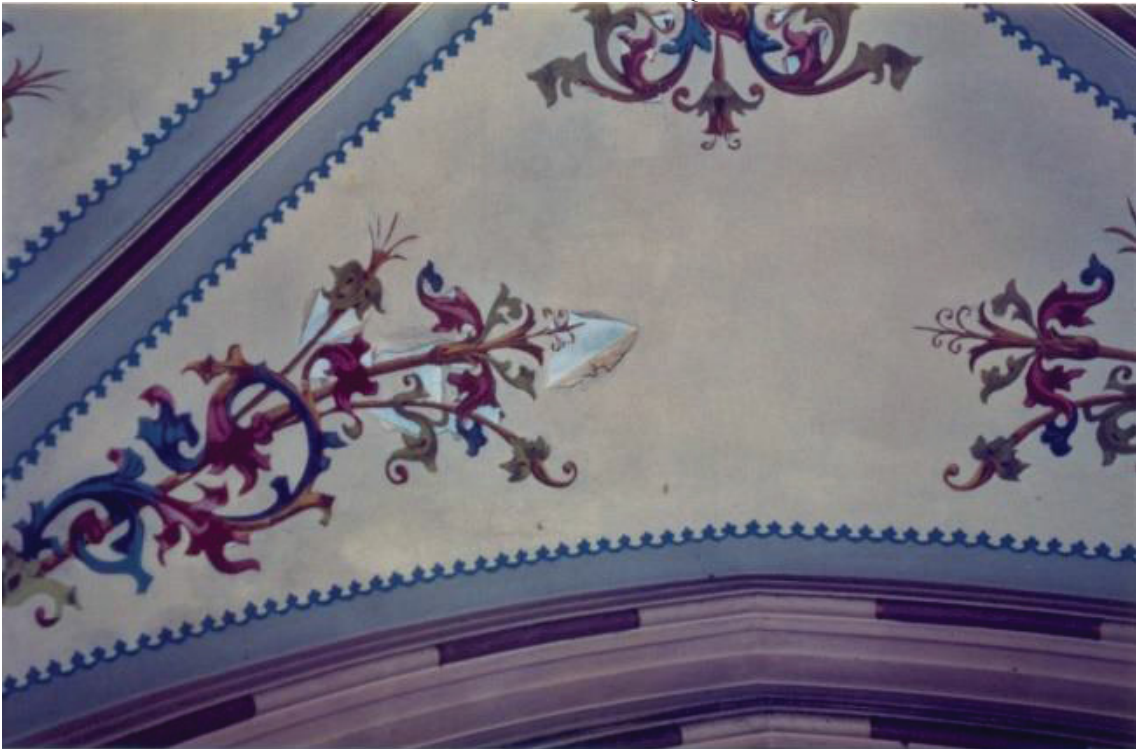
FIGURA 35 – PINTURA DANIFICADA NO ESTUQUE DAS NAVES LATERAIS
