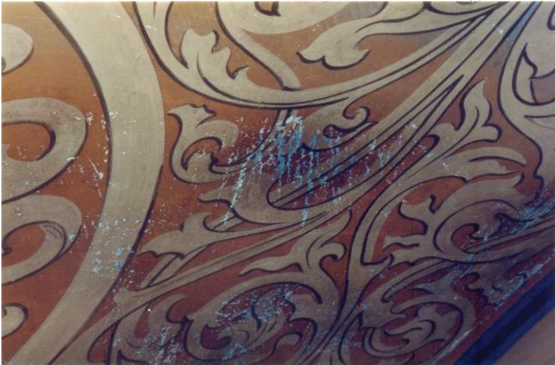
FIGURA 67 – MANCHAS NAS PINTURAS DA ABÓBADA CENTRAL (3)
