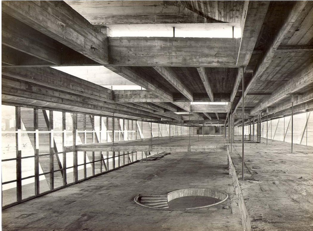
FIGURA 16 – INTERIOR DO MUSEU DE ARTE MODERNA DO RIO DE JANEIRO, DE AFFONSO EDUARDO REIDY.
