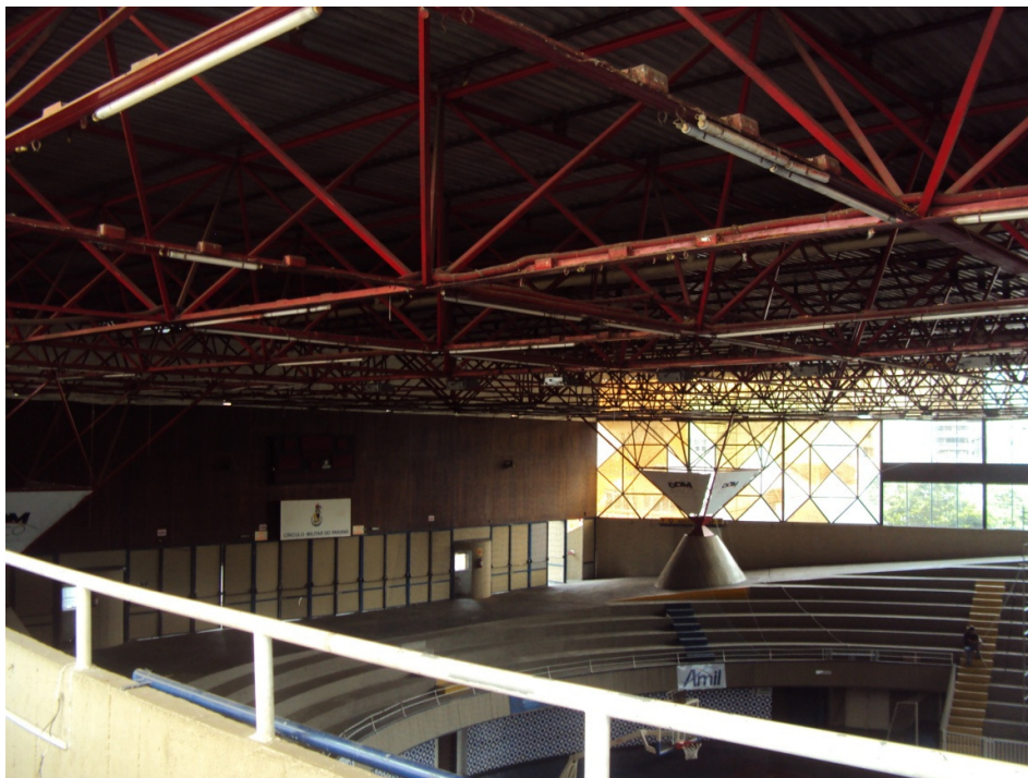
FIGURA 35 – Vista interna do ginásio do Circulo Militar do Paraná, mostra um dos apoios da cobertura em treliça espacial. Disponível em: acervo do autor
