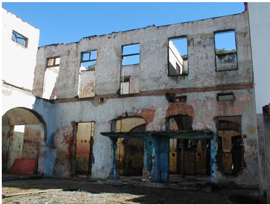
Figura 5.3.15 – Vista atual do estado de deterioração da fachada de fundos do prédio número 773 da Rua Barão do Rio Branco. (IPPUC, 2015)
