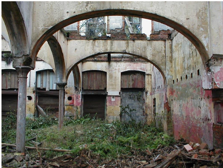
Figura 5.3.18 – Vista atual do interior do prédio número 773 da Rua Barão do Rio Branco, dominado pelo mato e transformado em depósito de entulhos. (IPPUC, 2015)
