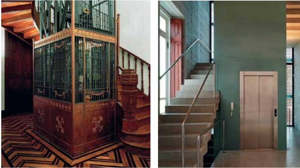
Figura 4.3.9 – Vistas do elevador original da obra e do elevador da nova torre de circulação do Palacete das Artes . (SERAPIÃO, 2013)
