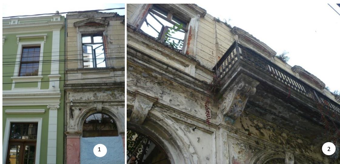
Figura 5.3.14 – Vista que mostra o contraste entre edificação restaurada e em uso (Prédio número 763) e a edificação abandonada e em ruína (Prédio número 773), à esquerda (1); e imagem aproximada do balcão e aberturas deterioradas, à direita (2). (AUTORA, 2015)
