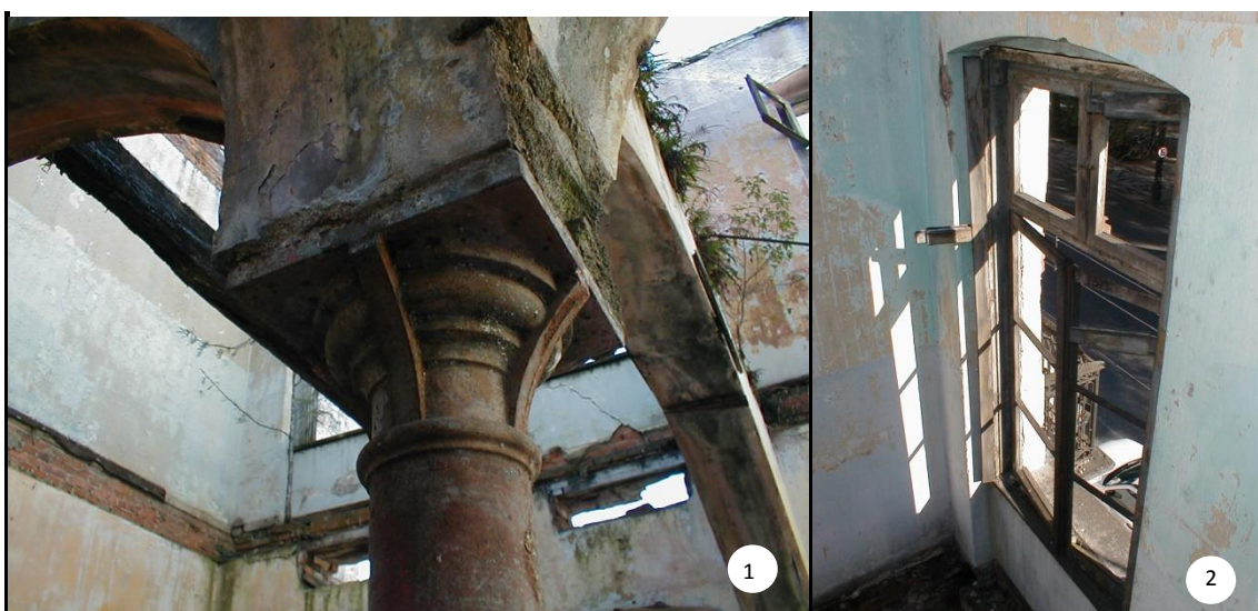
Figura 5.3.16 – Vista atual do estado de deterioração da parte interna do prédio número 773 da Rua Barão do Rio Branco, onde se observa, à esquerda, o capitel do pilar metálico (1) e, à direita, a situação das esquadrias de madeira (2). (IPPUC, 2015)
