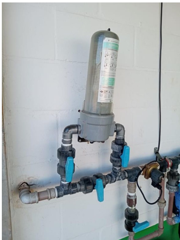
FIGURA 2: Filtro dosador de cloro
