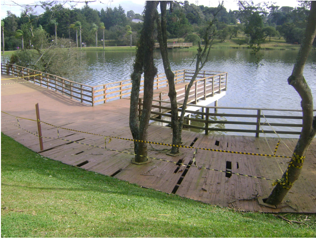
Fig. 3.14 – Deck parcialmente interditado.
