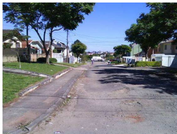
FOTO 12: Rua esburacada. FONTE: Acervo da Autora, 2009.
