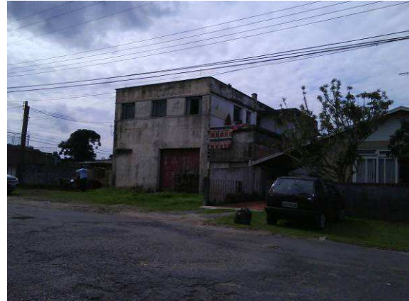
FOTO 4: Edifício degradado. FONTE: Acervo da Autora, 2009.
