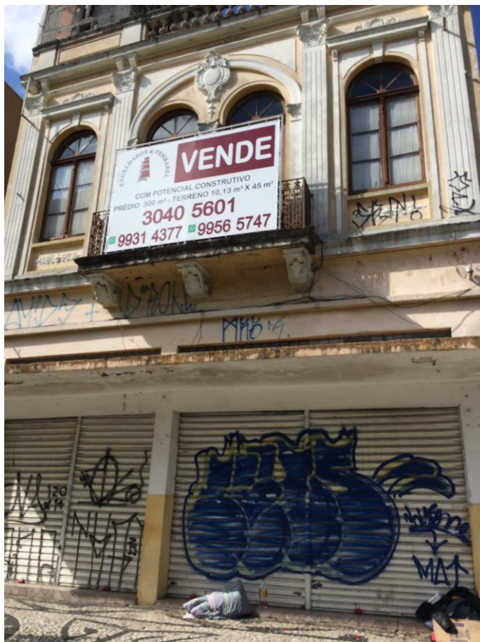
Figura 48 - Fachada do imóvel em 2016. Observa-se o acúmulo de sujidades e a rápida degradação por ação antrópica (vandalismo) desde o registro anterior. Fonte: Acervo da autora
