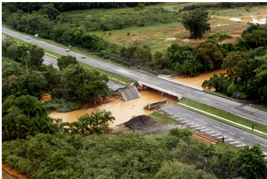
Figura 85 – Vista aérea da rodovia BR 277, danificada pelas chuvas de março de 2011. (KISSERNER, 2011)
