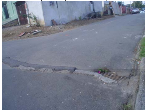
Figura 31 – Foto da ligação de esgoto na rede de águas pluviais (localização – Anexo 1)
